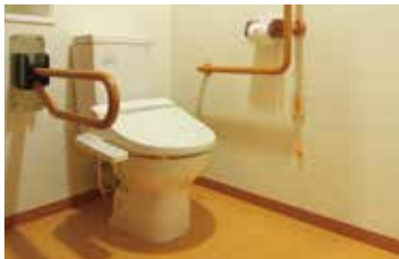
トイレ(Aタイプ)
